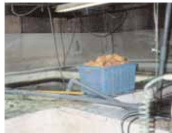
Wasserumwälzung im Tank eines Fischhändlers
